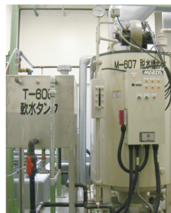
脱水機ボイラ
