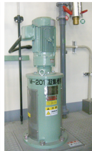
凝集槽攪拌機
