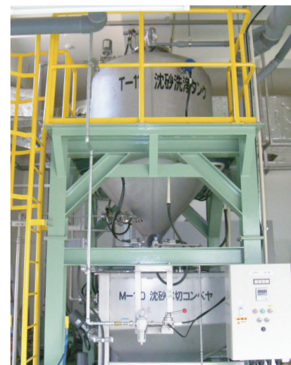
沈砂除去装置
