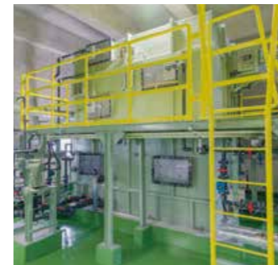
生物脱臭装置
